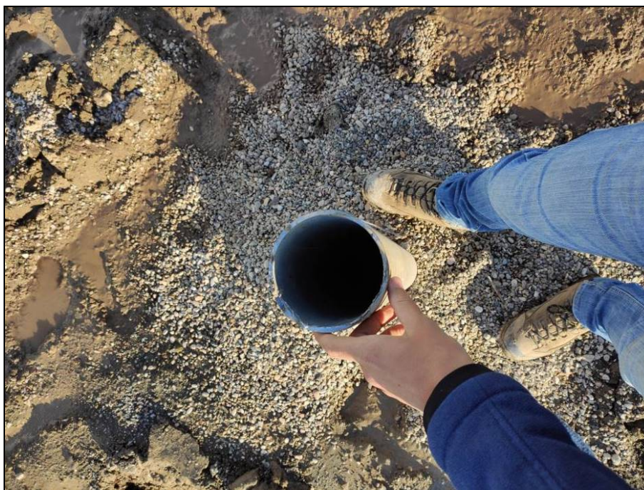
Tubazione metallica di rivestimento del piezometro messo in opera sulla verticale del sondaggio S1.
